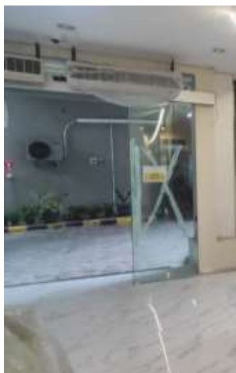
Gambar 7 Gap antara ramp dan lantai vinyl pada pintu masuk Lobby Persada Hospital Sumber Dokumentasi Penulis, Januari 2026
